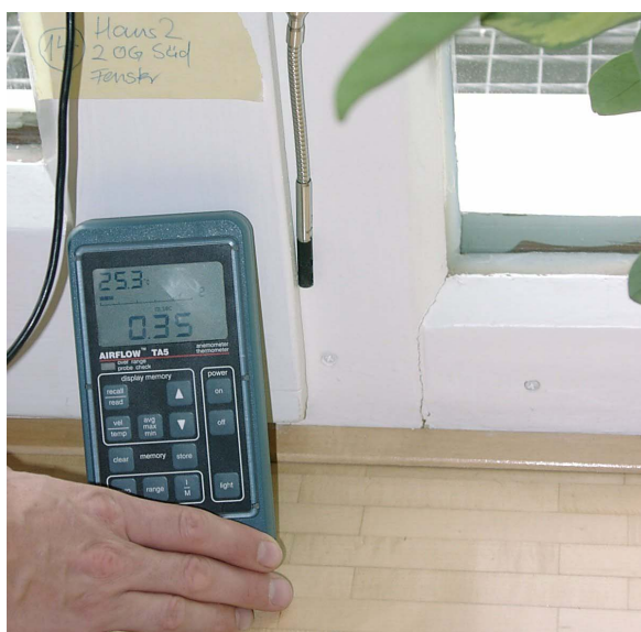
Abbildung 14: Leckage an Verschluss-Seite der Balkentür.
