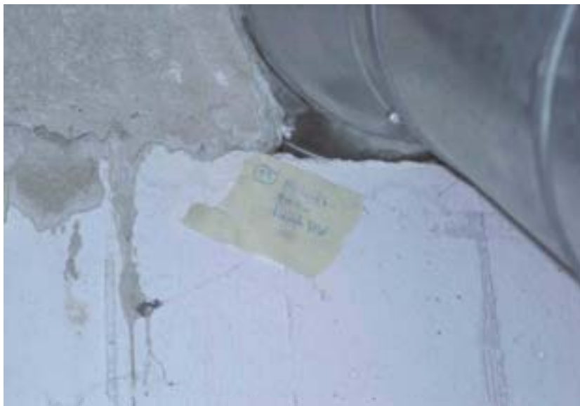
Abbildung 30: Leckage am Wanddurchbruch für den Fortluftkanal. (Anmerkung: Der Fortluftkanal sollte im warmen Keller auf jeden Fall gedämmt sein.)
