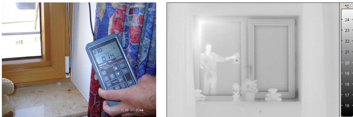
Abbildung 76: Innenthermographie eines Fensters. Die Abbildung rechts zeigt das Fenster bei Unterdruck. Am Fensterbeschlag rechts unten ist eine schwache Kaltluftfahne erkennbar.
