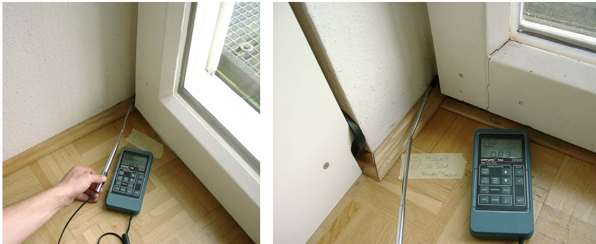
Abbildung 17: Leckagen am unteren Fensteranschluss. Balkon 1. OG.
