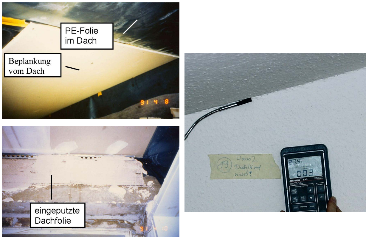
Abbildung 16: Anschluss Trennwand Dach. Anschluss der Dachfolie in der Bauphase (links) und (rechts) Riss in der Tapete durch Setzung. Die luftdichte Ebene wurde durch die Baubewegung nicht beschädigt.
