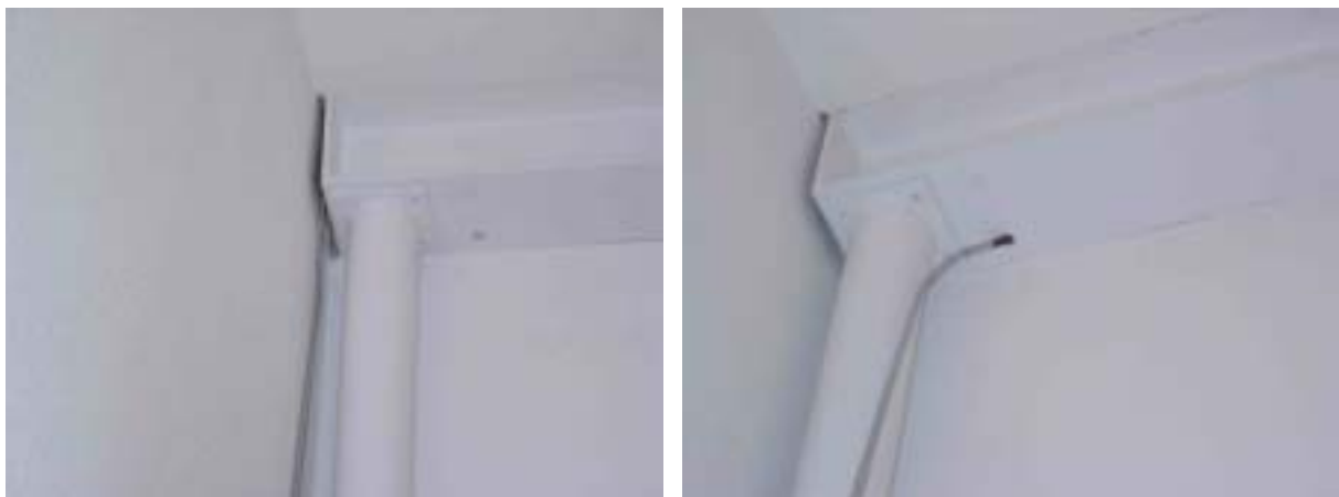
Abbildung 34: Restleckagen vermutlich am Anschluss Dach/Außenwand hinter dem Querträger.
