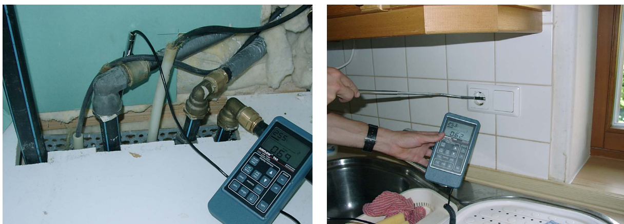
Abbildung 55: Links: Leckagen an der Einführung der Wasserleitungen durch den Erdgeschossfußboden. Rechts: Undichtheit der Steckdose in der Küche im EG.
