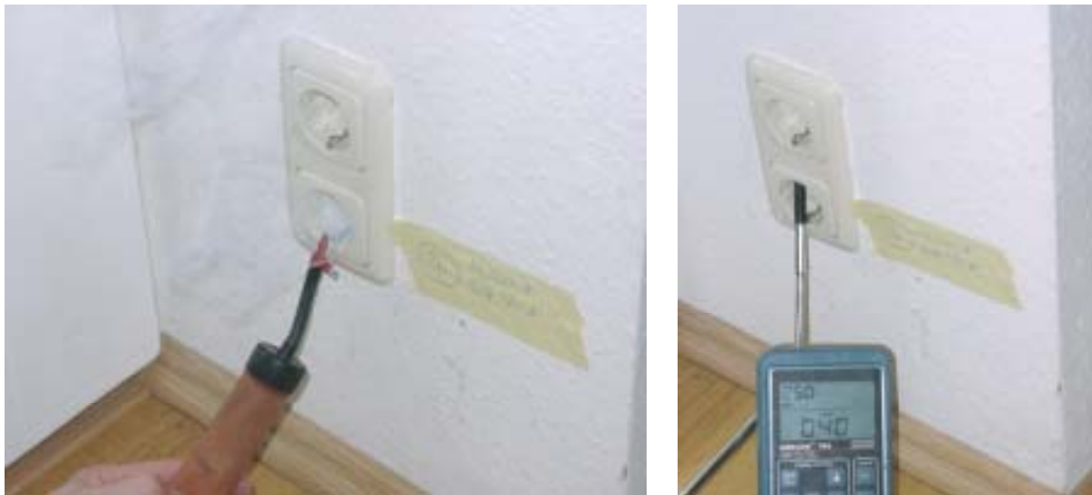
Abbildung 20: Leckage zum Installationsschacht (Nachweis links mit Rauchfahne, rechts mit Thermoanemometer).
