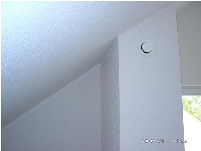
Abbildung 81: Keine Restleckagen am Dachanschluss.
