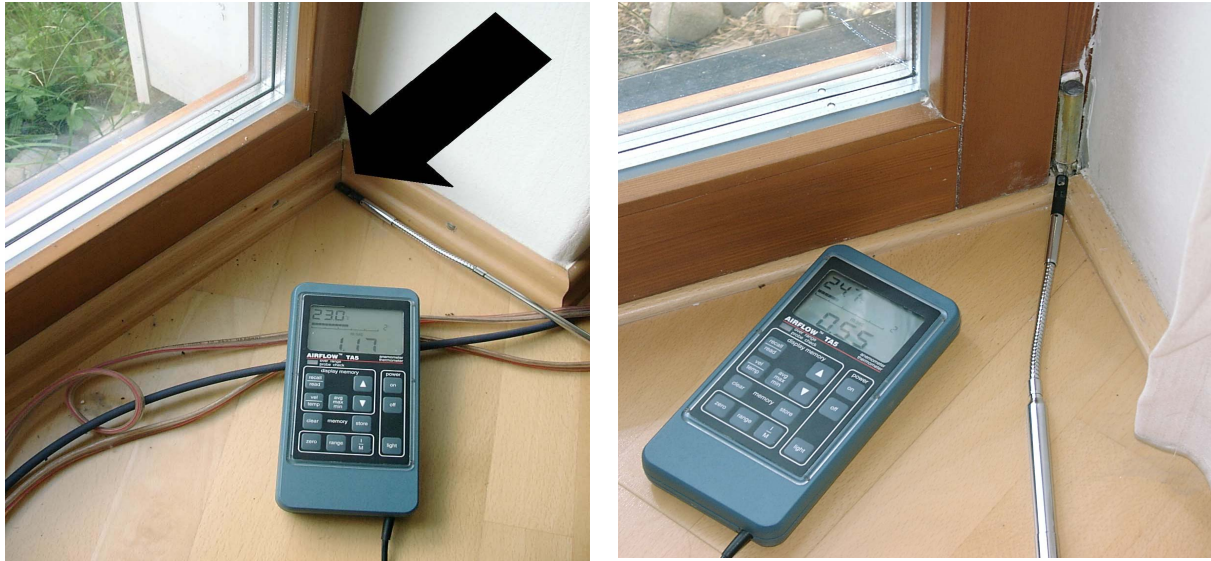
Abbildung 53: Undichtheiten beim Passivhaus Bamberg im EG in der Laibung beim Anschluss Festverglasung bzw. Fenster an den Fußboden/Bodenaufbau.
