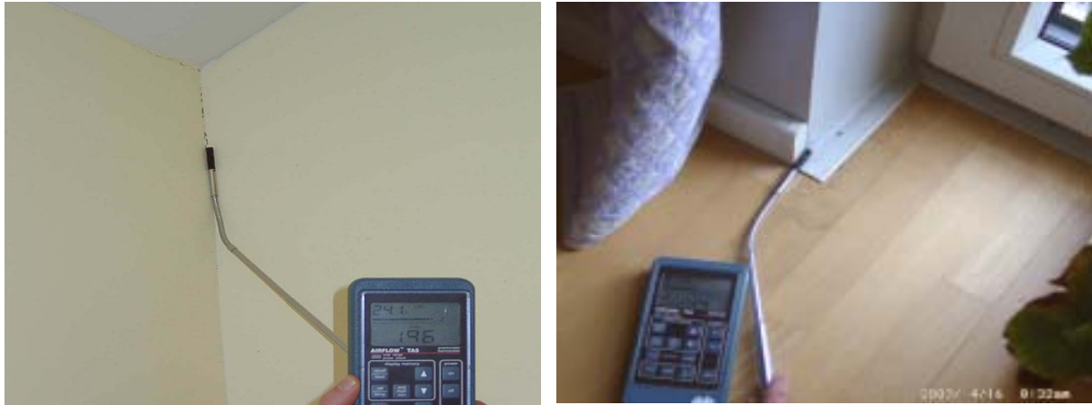
Abbildung 68: Links: Leckage an der Kante Außenwandelement zur Haustrennwand, Abriss der Fuge durch Bauteilbewegungen. Rechts: Leckage an der Ecke der Fensterleibung zum Fußboden.
