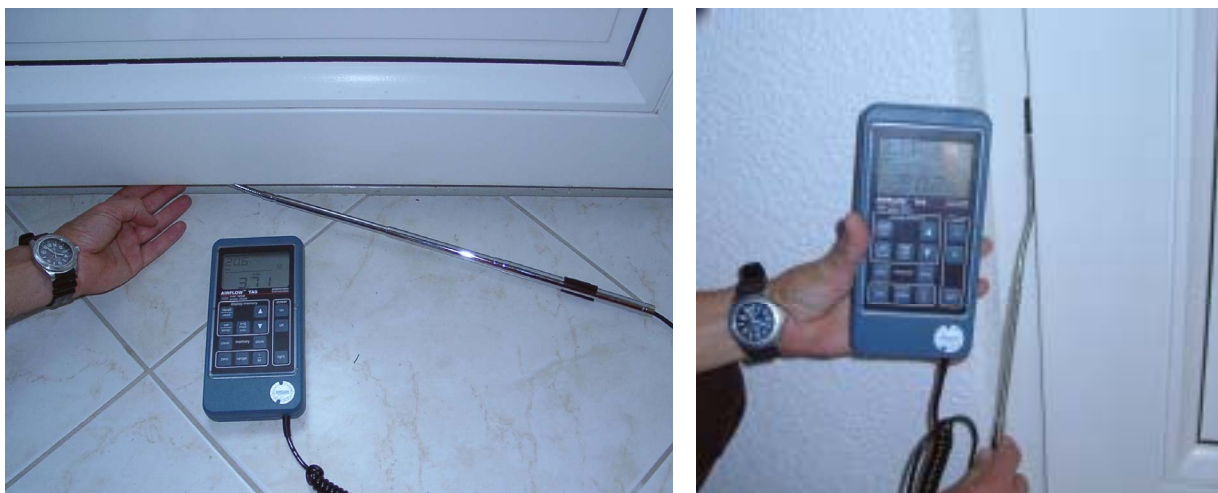
Abbildung 78: Die Hauptleckage in diesem Haus stellt ebenfalls die Haustür dar.
