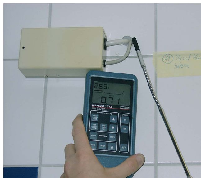
Abbildung 15: Kabeldurchführung. Interne Leckage in der Trennwand zum Nachbarhaus.
