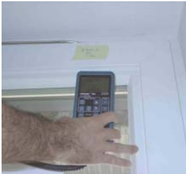
Abbildung 32: Leckage an der Haustür.
