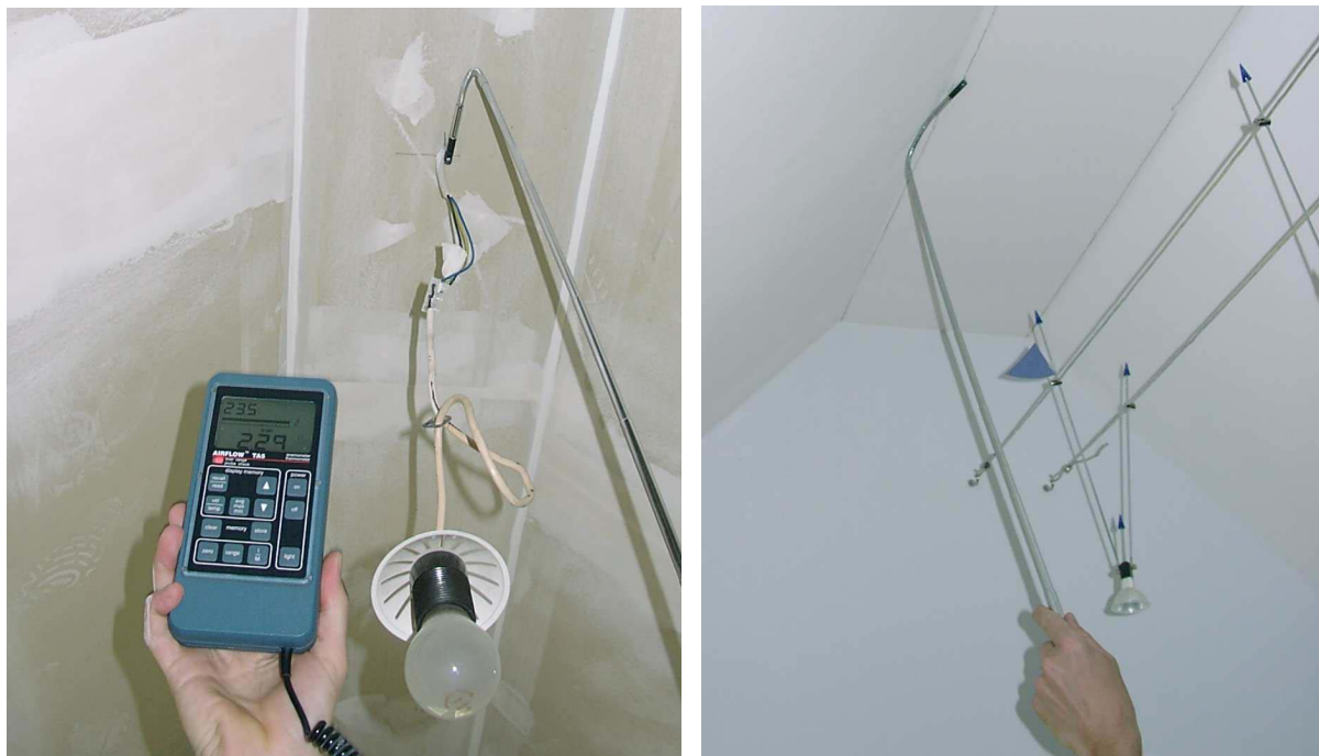
Abbildung 58: Leckagen im Passivhaus Stegaurach an der Kabeldurchführung der Deckenlampe in einem Abstellraum und an der Fuge der Gipsverkleidungsplatten im Giebel (unterhalb der Firstpfette).
