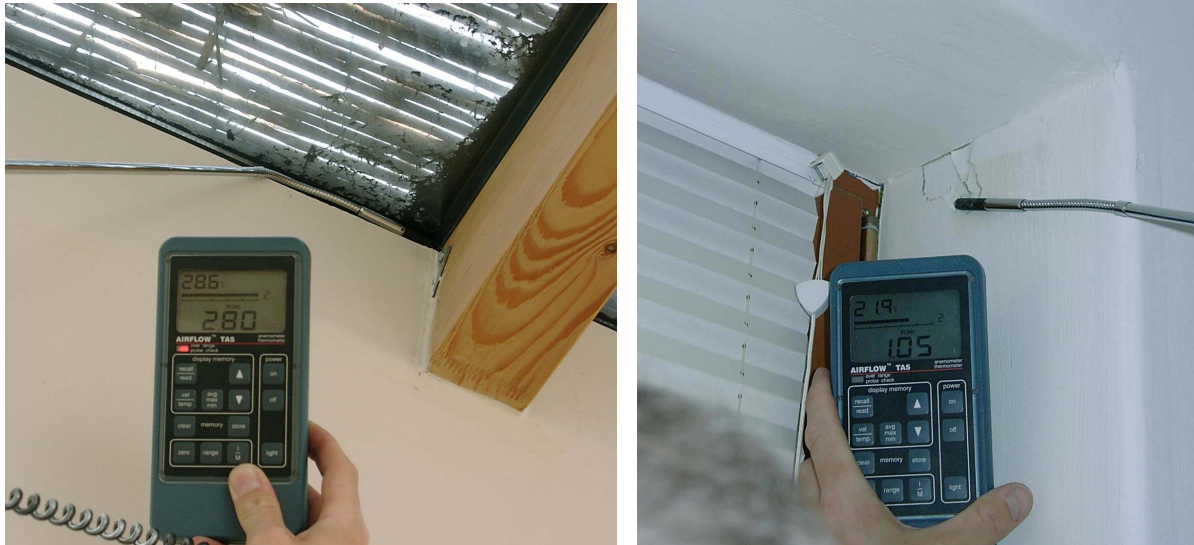
Abbildung 56: Links: Undichtheit der Festverglasung im Dach (Sommersonnenschutz durch außen aufgelegte Schilfmatte). Rechts: Leckage an beschädigter Gipsplatte (durch die Seileinführung der innenliegenden Jalousie am Fensterflügel).
