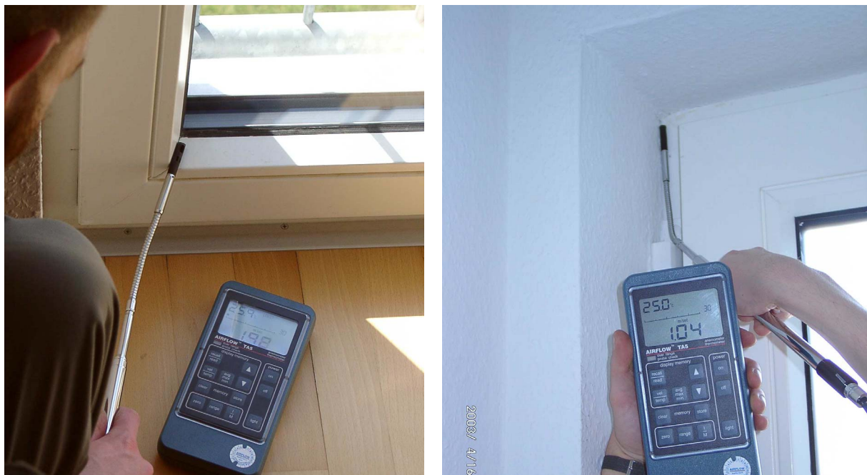
Abbildung 67: Links: Nachgewiesener Leakagestrom an der Verbindungsstelle der Glasleisten. Rechts: Kleinere Undichtheit bei der Einbindung der Türrahmen an die PE-Folie des Leichtbauelementes.
