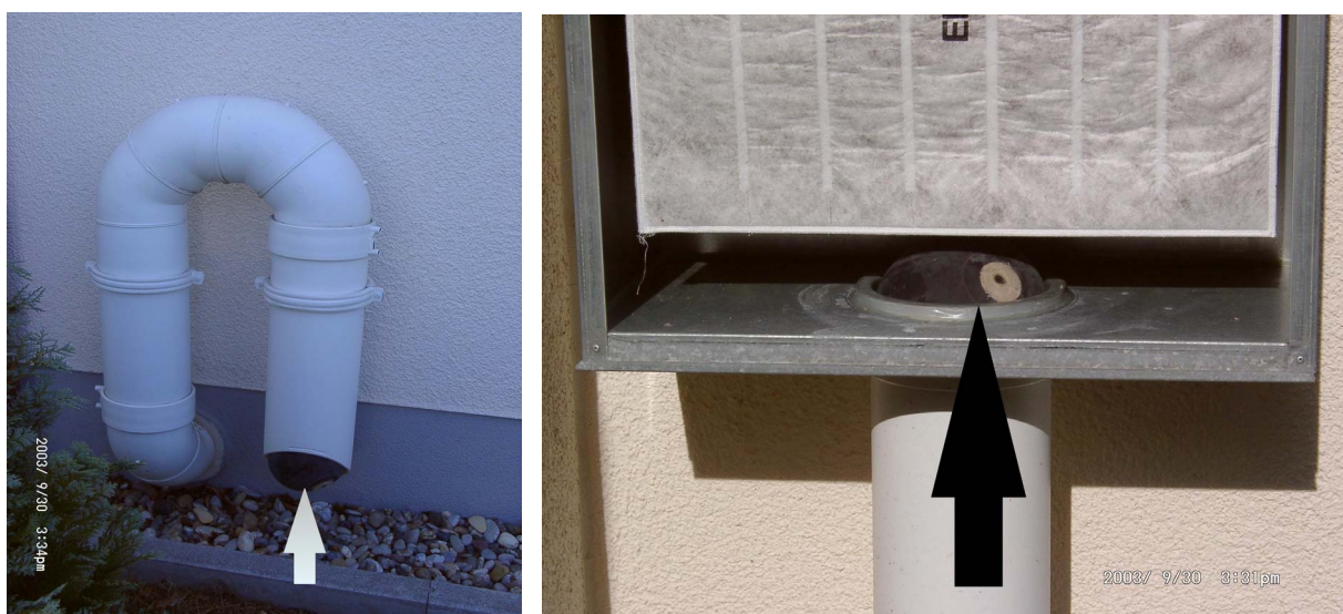
Abbildung 73: Verschluss des Lüftungssystems beim Drucktest in Bühl. In Außenluftein- und Fortluftauslass sind jeweils Gummiblasten gesetzt.
