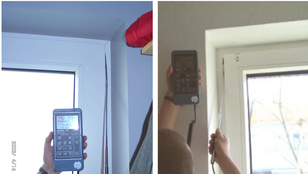
Abbildung 66: Undichtheiten an der Haustür- (rechts) und Fensterdichtungen (links). Diese Leckagen könnten durch Nachstellen v on Tür und Fenster behoben werden.
