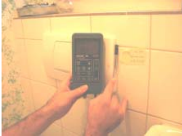
Abbildung 46: Restleckage an der Vorwandinstallation am WC-Spültaster.
