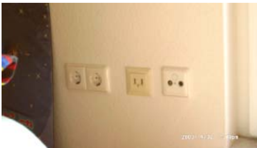
Abbildung 80: Das Antennenkabel durchdringt die Außenwand. Die Elektroinstallation ist in den Schalungssteinen vergossen. Es wurden keine Leckagen festgestellt.
