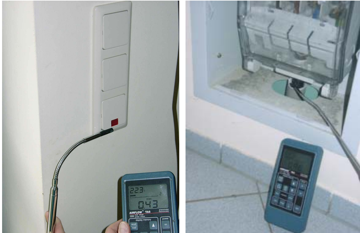
Abbildung 57: Kleinere Leckagen im Passivhaus Stegaurach an Lichtschaltern in der Außenwand und an der Kabeldurchführung im Leerrohr durch die Bodenplatte.
