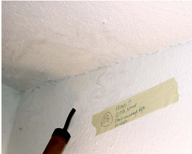
Abbildung 21: Bewegungsrisse bei Anschluss Dach/Giebelwand. Keine Leckage feststellbar (Rauchtest).
