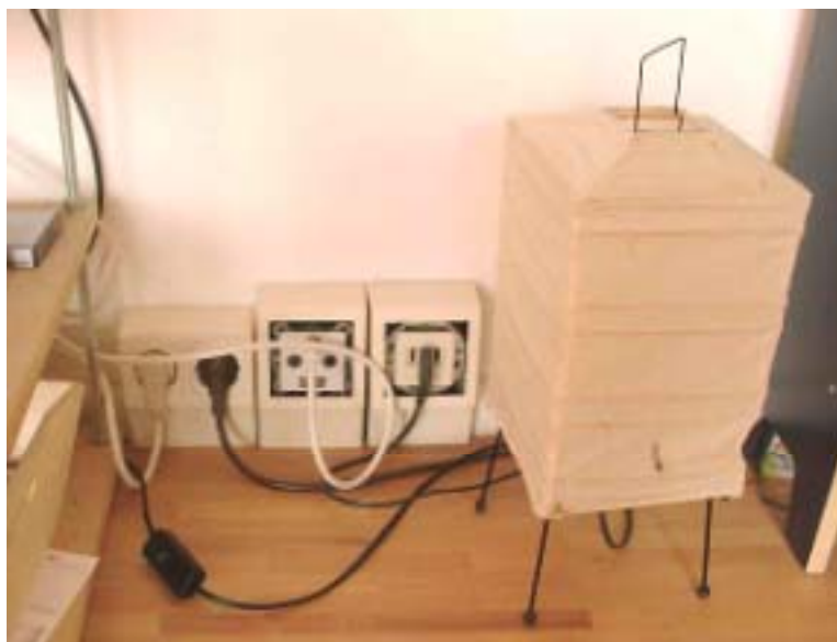
Abbildung 40: An den Außenwänden sind nur Aufputzsteckdosen eingesetzt. Die elektrischen Versorgungsleitungen verlaufen in den Fußleisten.
