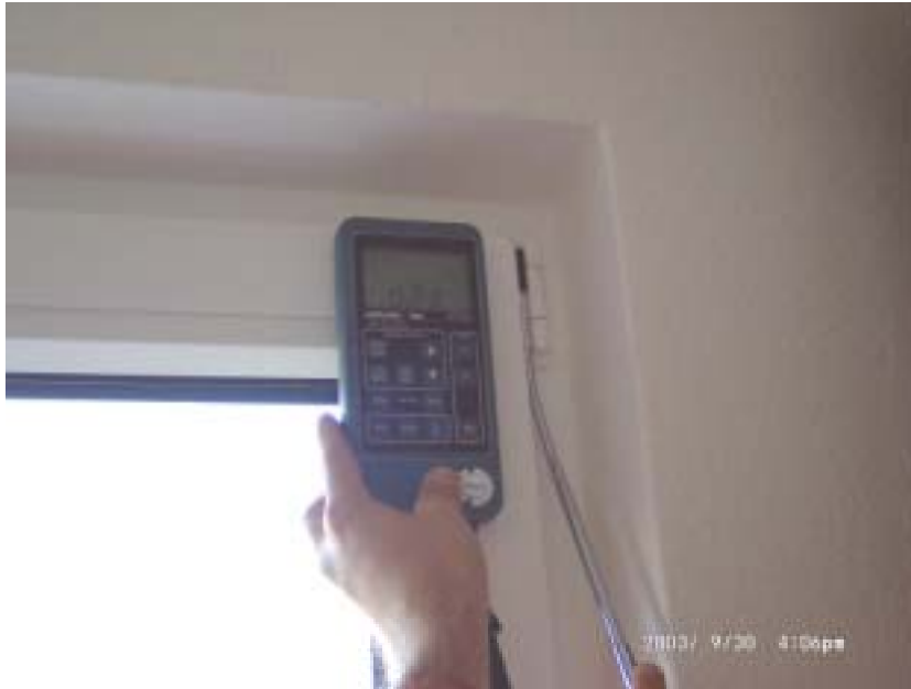
Abbildung 79: Restleckage an der Beschlagseite eines Fensters.
