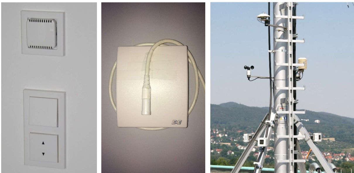
Abbildung 15: Links: Fertig montierte Temperaturmessstelle in einer Unterputzdose über einer Schalterkombination in einem Büroraum. Mitte: Kombisensor Temperatur/Luftfeuchte/CO 2 in einem Büroraum während der Kalibriermessung mit einem autarken Datenlogger (nur der Sensorkopf im Bild) Rechts: Wettersensoren montiert an einem Funkmast auf dem Dach.
