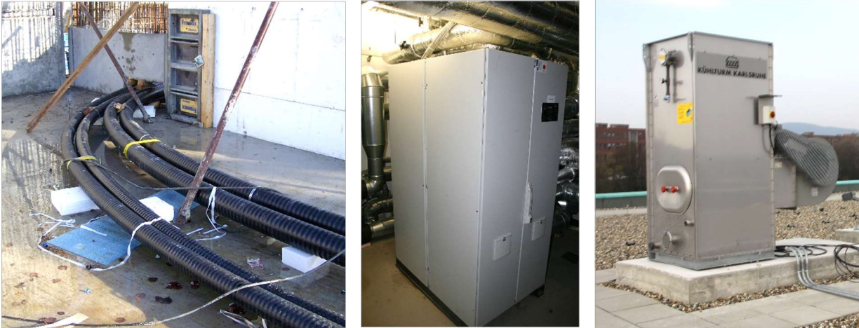
Abbildung 26: Links: Sammelrohrleitung (VL/RL) der Erdsonden während der Bauzeit Mitte: Gehäuse mit den beiden Wärmepumpen im Technikraum im 2. OG Rechts: Kühlturm auf dem Dach des Gebäudes direkt über dem Technikraum
